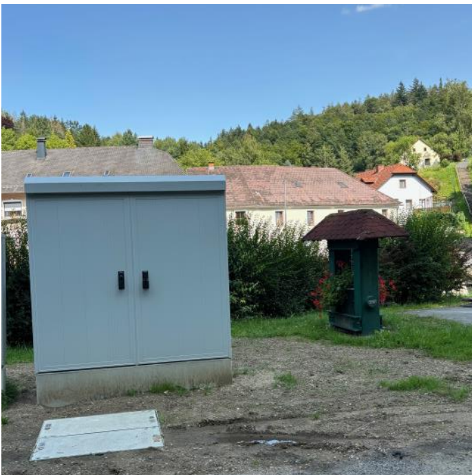
In Messern wurde im Bereich der Taffabrücke der Hauptverteiler (POP) für vier Orte installiert
